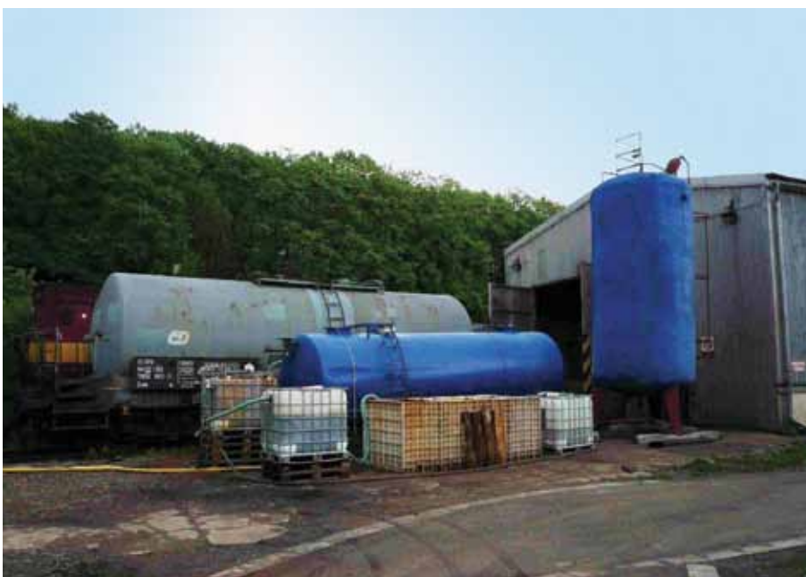
Obr. 5.2.4. Trutnov, depo Českých dráh – časť stanice čistenia podzemných vôd a biofermentor (archív DEKONTA, a. s.).
