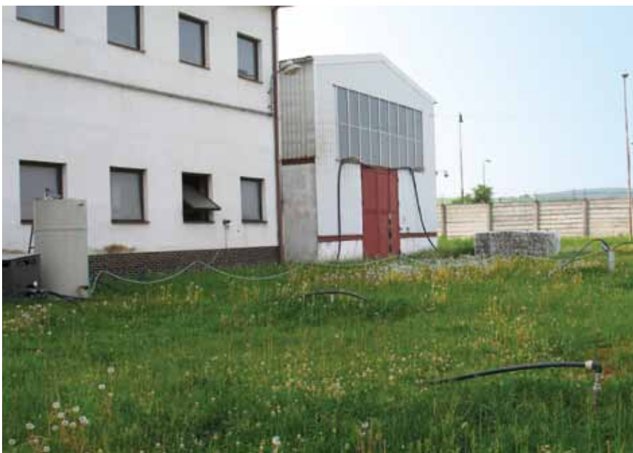
Obr. 5.2.10. Uherský Brod, areál spoločnosti Česká zbrojovka, a. s. – technologické vybavenie lokality (airliftový bioreaktor, dúchadlo, aplikačné sondy) (foto EPS, spol. s r. o.).
