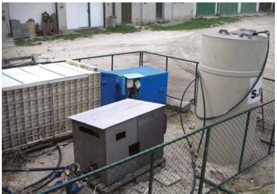
Obr. 5.1.14. Rajecké Teplice, čerpacia stanica pohonných hmôt – sanačná jednotka (bioreaktor, dúchadlo, gravitačno-sorpčný odlučovač) (foto EPS biodegradácie, s. r. o.).
