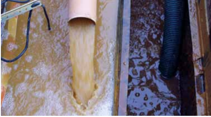
Obr. 5.1.29. Košice, Haniska, areál SPP, a. s. – kontaminovaná podzemná voda na vstupe do dekontaminačnej stanice (archív ENVIRONCENTRUM, s. r. o.).
