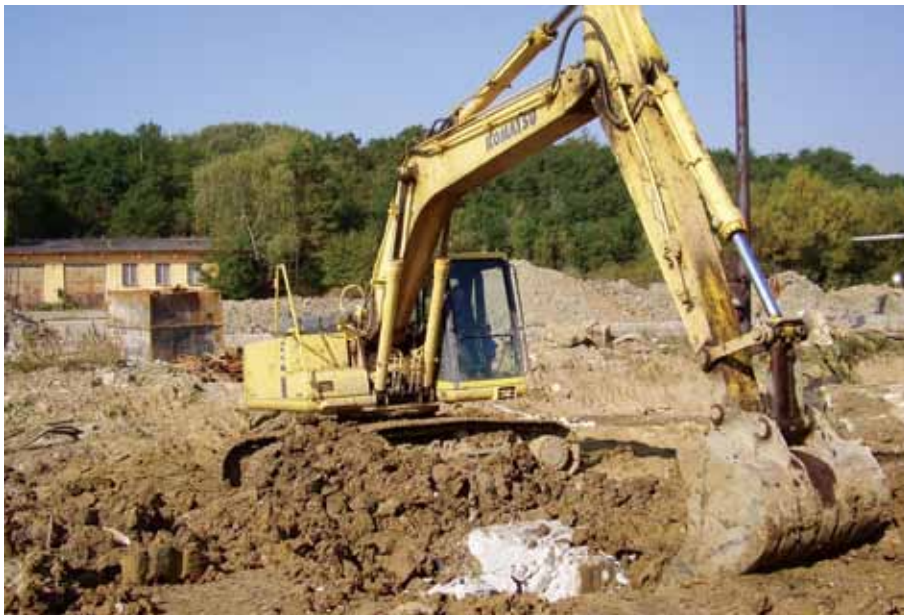
Obr. 5.1.4. Pozdišovce, bývalý distribučný sklad Slovnaftu, a. s. – demolácia základov bývalých objektov a selektívna ťažba zeminy (Dekonta Slovensko, 2009).
