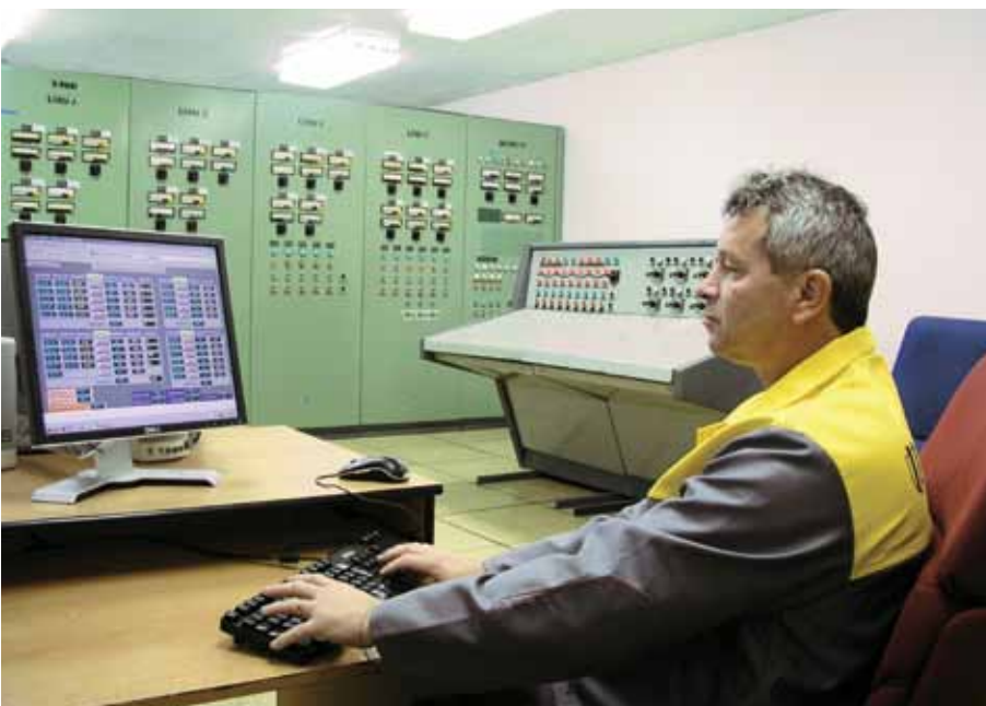
Obr. 5.1.31. Bratislava, areál Slovnaftu, a. s. – riadiace centrum hydraulického clony (archív GEOtest Bratislava, s. r. o.).
