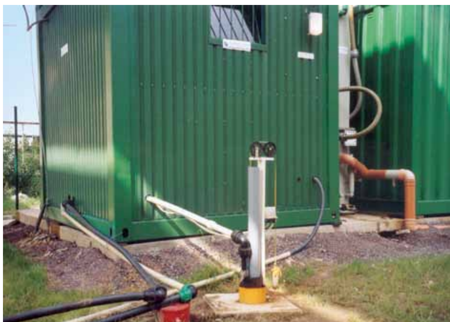
Obr. 5.1.17. Sanačný vrt s hladinovým spínačom (foto HES-COMGEO, spol. s r. o.).
