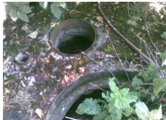
Obr. 4: Šachta k podzemnej nádrži
