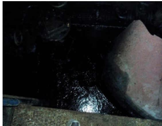
Obr. 8: Zaplavená časť strojovne
