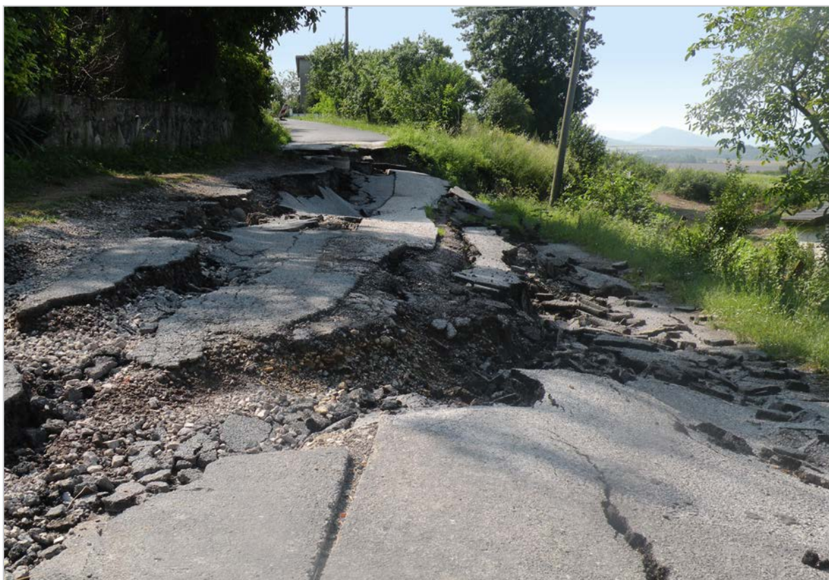
Obr. 23: Poškodená miestna komunikácia v Nižnej Myšli
