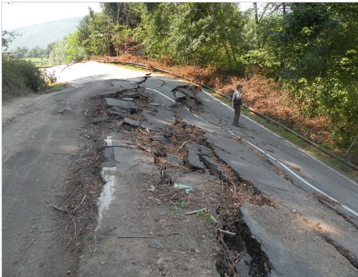
Obr. 24: Zosuvom poškodená cesta v obci Miňovce
