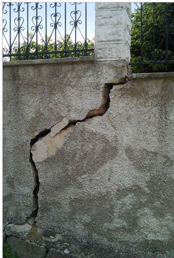
Obr. 21: Porušený oporný múr v Nižnej Myšli
