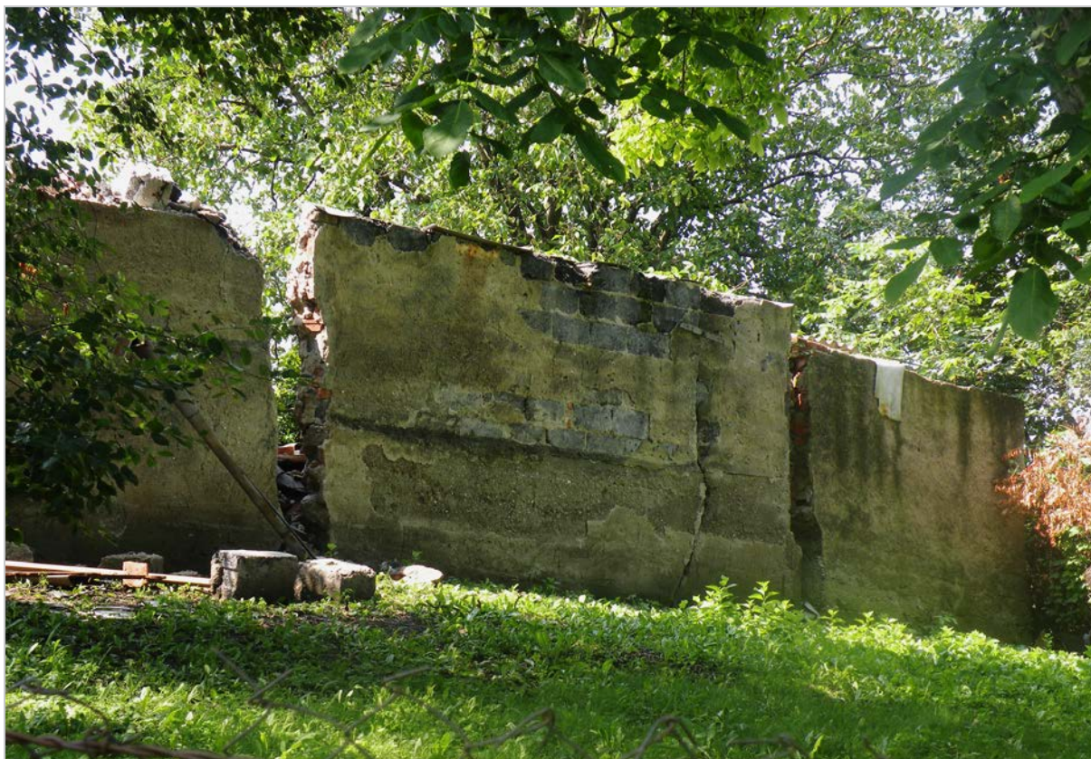
Obr. 22 a, b: Príklady rôznych trhlinami porušených objektov
