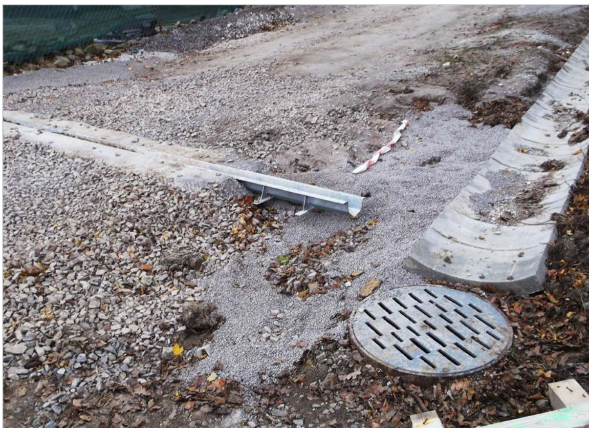
Obr. 61: Prievidza-Hradec – odrážky a drén na ceste (2014)
