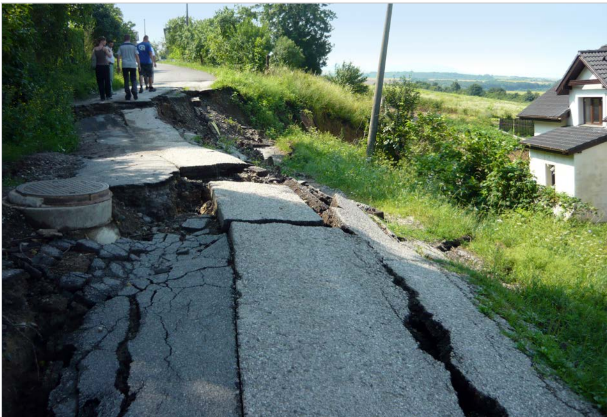
Obr. 88: Nižná Myšľa – poškodená komunikácia (2010)
