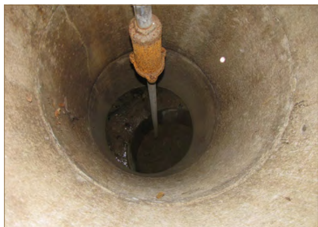
Obr. 9.24: Záchytená šmyková plocha (posun skruže) v domovej studni (foto: M. Kopecký)
